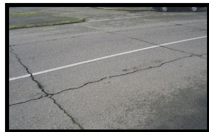
Agrietamiento reflejo de las juntas de las losas de base en un vía arterial urbana
