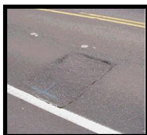
Un parche situado encima de un área donde el pavimento o sus capas de base han cedido
