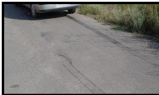
Desalineación en una huella de deslizamiento
