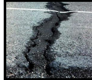
Las temperaturas bajas conllevan un cambio de volumen de los materiales del pavimento, y tienen como resultados un agrietamiento termal
