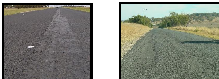
Desagregación de una carretera recién hecha y de una con una cierta antigüedad
