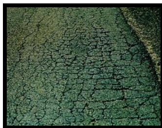
Agrietamiento estructural severo, que permite la filtración del agua en todas las capas del pavimento
