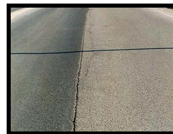
Agrietamiento en la junta por una inadecuada localización y por deficiente construcción
