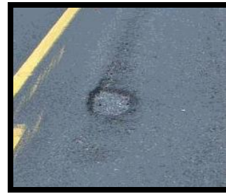
Bache debido a un problema superficial
