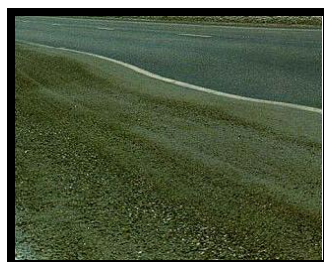
Un badén en el borde de la calzada, probablemente debido a una infiltración de aguas en el pavimento o en sus capas inferiores
