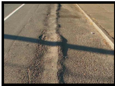
Rodera por falta adecuada de compactación
