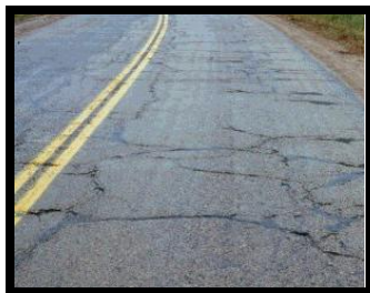
Agrietamiento generalizado o masivo
