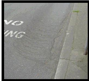
Agrietamiento por hundimiento cerca de una parada de autobús, causado por las aceleraciones y frenadas de los vehículos pesados
