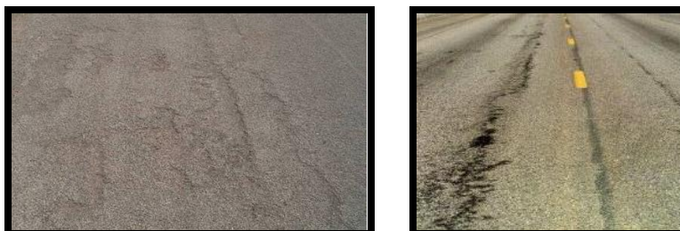
Descascarillamiento por envejecimiento y en la rodada de una carretera
