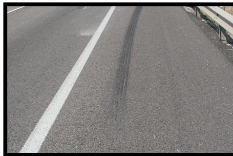
Inicio de una huella de deslizamiento
