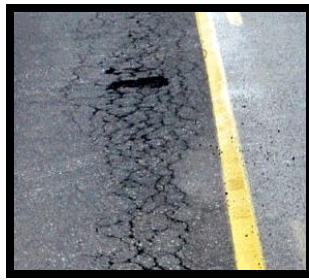
Bache debido a una fisuración por fatiga
